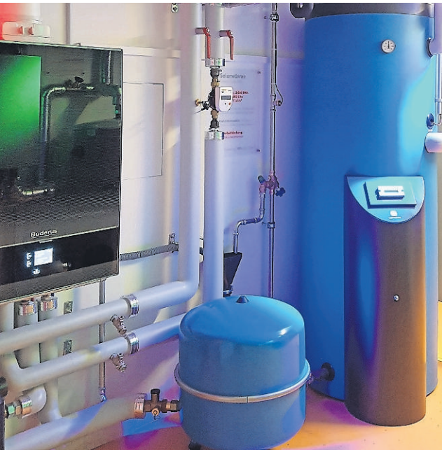
Links ist die Gastherme, rechts der Solarboiler. Die neue Wärmezentrale dient gleichzeitig als Showroom.
